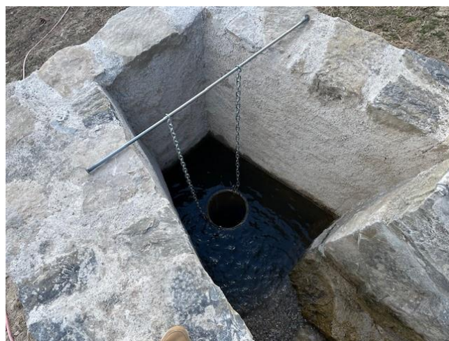
24.03.25 chambre ruisseau DP 391
